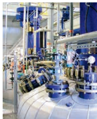
Um diese Anlage wurde die Produktion der Hypolauge erweitert.
