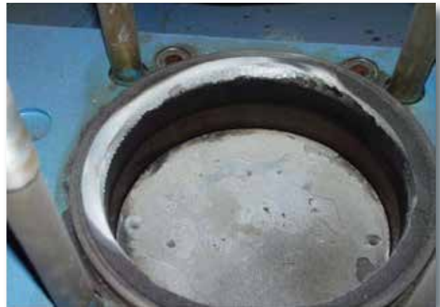
Siliziumdioxid-Ablagerungen an Zylinder und Ventil eines mit Klärgas betriebenen BHKW
