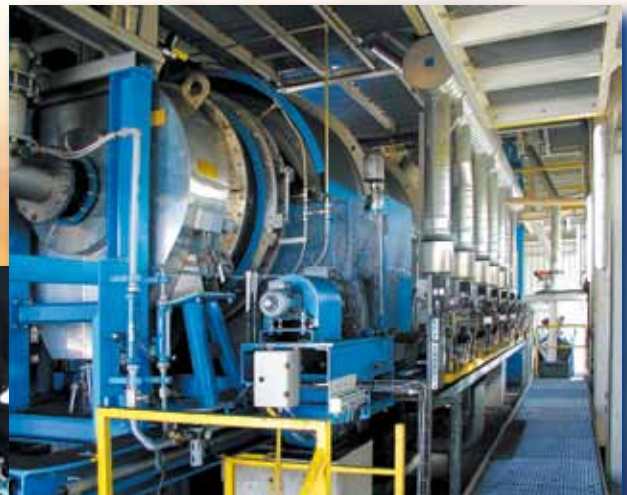
Donau Carbon Reaktivierungsanlage in Pischelsdorf (Österreich) Donau Carbon Reactivation Plant in Pischelsdorf (Austria)
